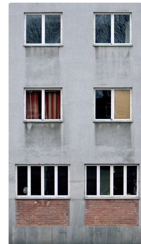
Figur 7. Sålbenkbeslagene beskytter området under vinduet slik at smuss og forurensning ikke blir vasket av. Her er altså den utstikkende dryppkanten trolig for stor. Dette problemet vil kunne gjelde for lite slagregnutsatte fasader i bystrøk med en del forurensning/trafikkstøv. Nederst på fasaden er problemet unngått ved å benytte et annet materiale hvor skitten ikke blir synlig.
