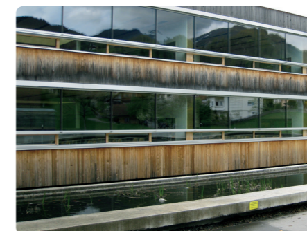
Figur 5. Ustikkende sålbenkbeslag «beskytter» underliggende ubehandlet trekledning, og hindrer den naturlige gråningen man ønsker å oppnå. Denne fasaden mottar relativt lite slagregn, noe som fører til at beslagets skjermende virkning blir stor. Lenger opp på veggen er treverket mer grånet på grunn av mer slagregn. Her burde man trolig hatt mindre beslagsutstikk.
