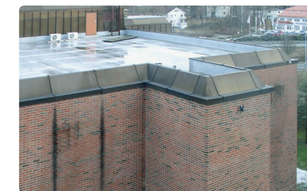
Figur 2. Tilbaketrakket parapet fører ugunstige mengder vann ut mot fasaden. Det blir skittstriper fordi regnvannet presses opp mot skjøtene (falsene) i beslaget og vannet renner videre i konsentrerte strømmer.
