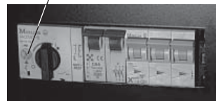
Inställning av motorskydd
