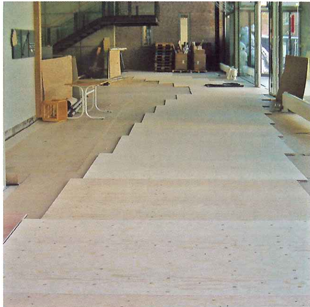
Figur 10: Ferdiglagte gulv skal ha solid beskyttelse som skal ligge i hele byggeperioden.
