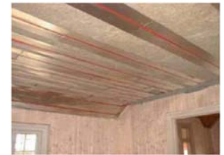
Prototyp takvarmesystem (SINTEF Byggforsk)
