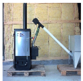
Pelletskjel med pelletsilo og skrue
