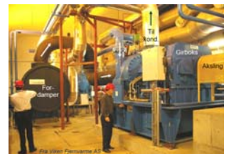
Skøyen Vest varmesentral har kjoakkvarmepumpe (28 MW)
